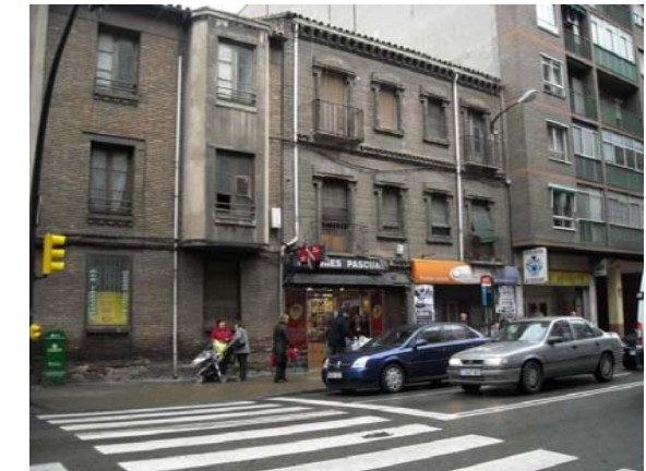
La mayor parte del tramo junto al centro de la ciudad presenta fachadas ennegrecidas o en mal estado de conservación.
