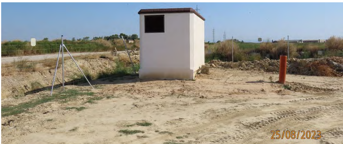
Ilustración 6. Centro de seccionamiento.
