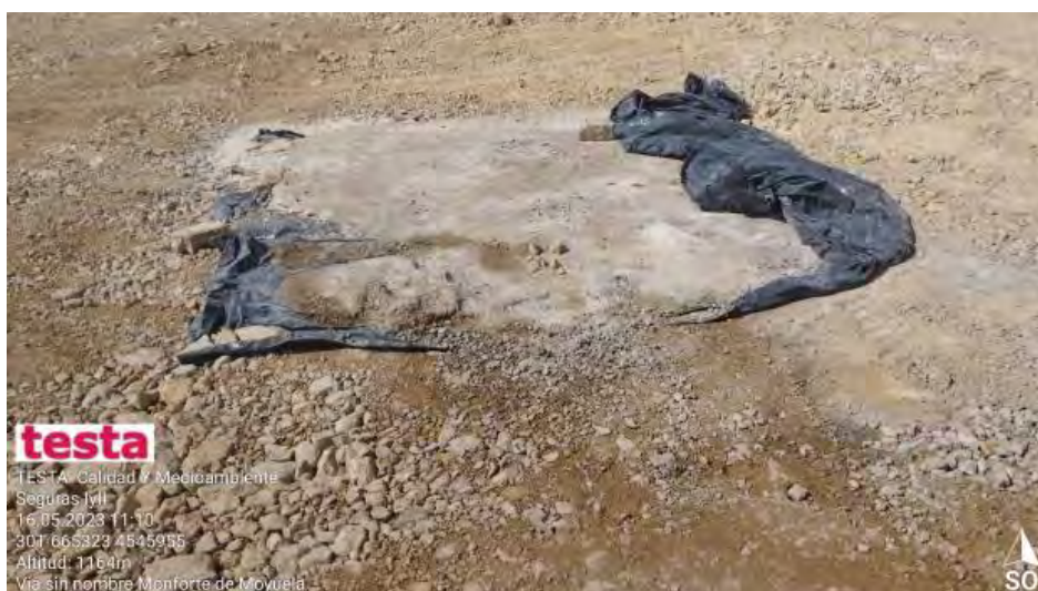
Restos de hormigón en SE2-10 sin gestionar adecuadamente
