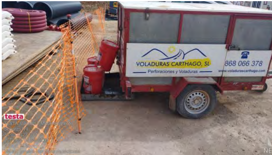
Nueva maquinaria de repostaje , protegida
