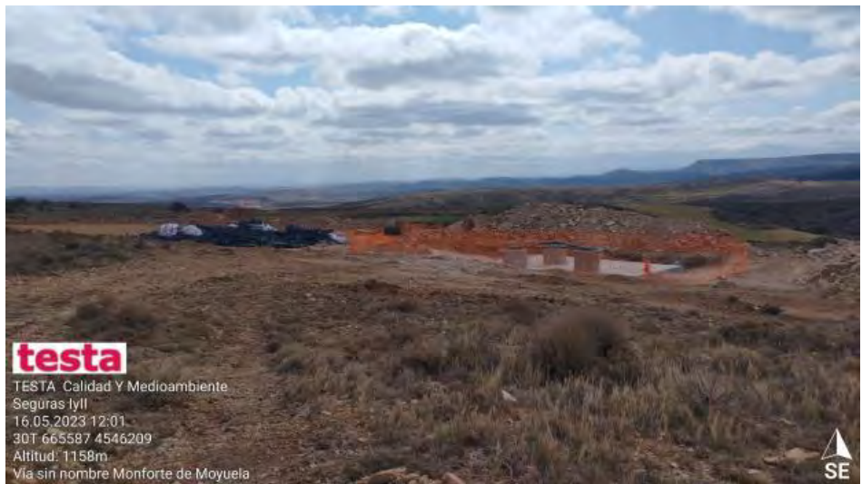
Torre meteorológica sin pozo de lavado
