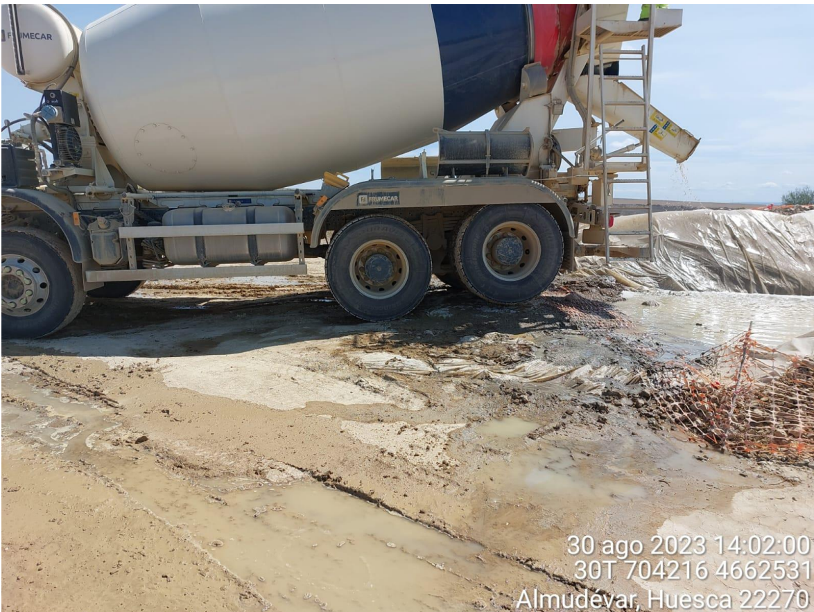
Imagen 2. No conformidad leve debido al desbordamiento del pozo de lavado de SIS-04.
