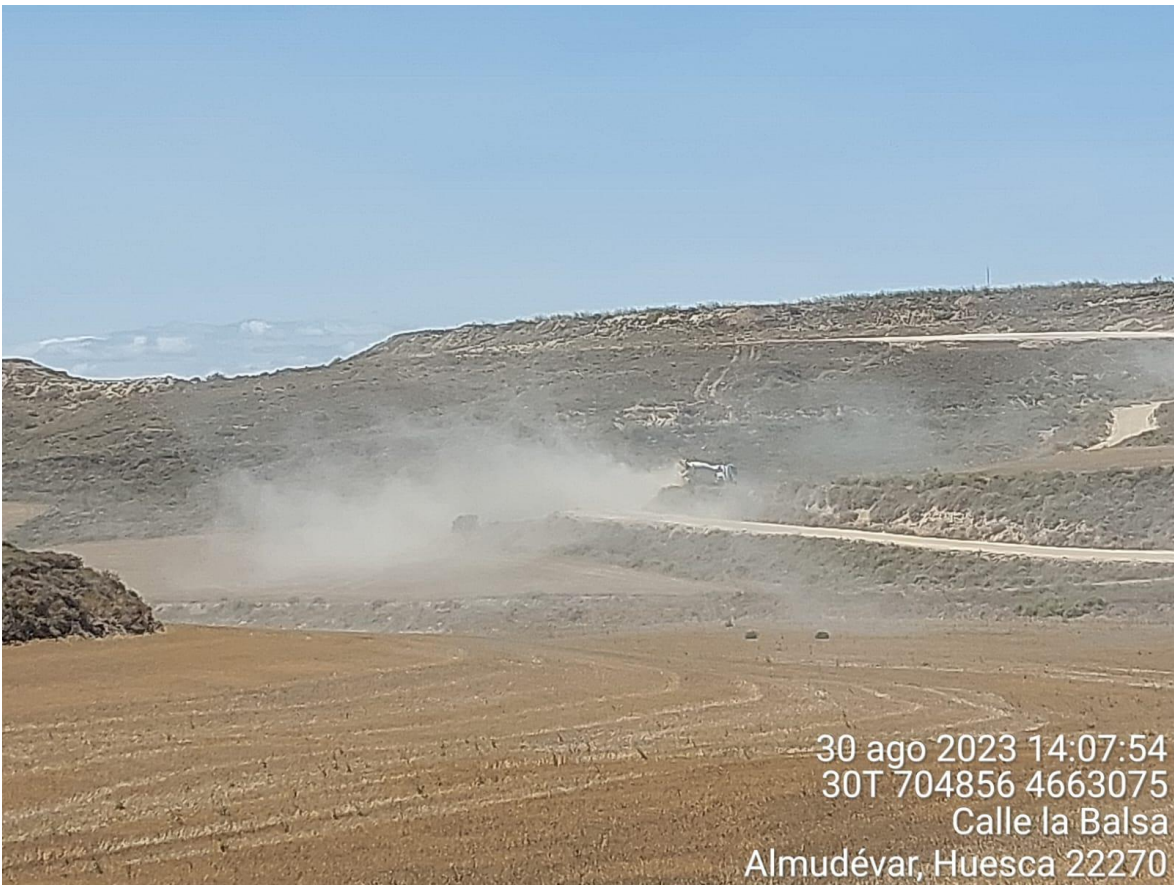
Imagen 1. No conformidad leve debido al polvo generado por el paso de hormigoneras en el camino que lleva a SIS-04.
