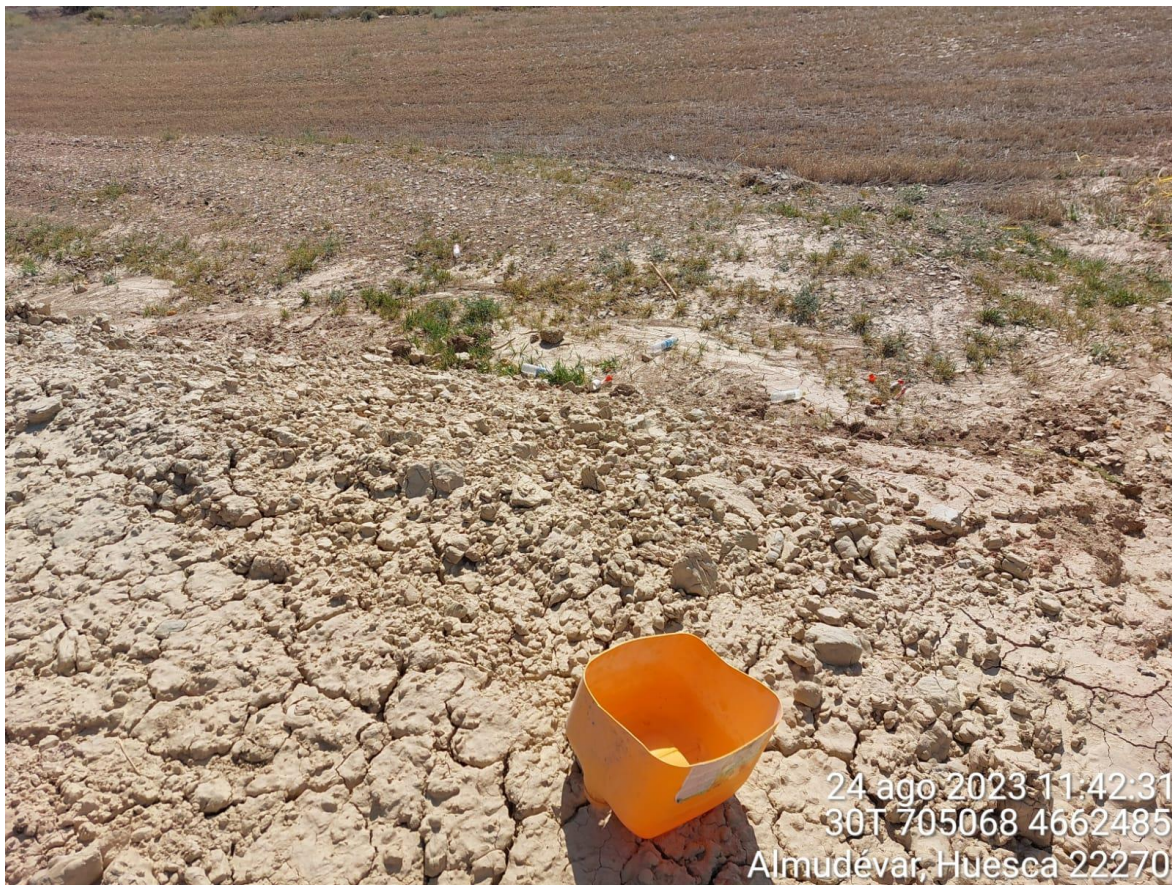
Imagen 1. No conformidad leve. Residuos y basura en la obra.
