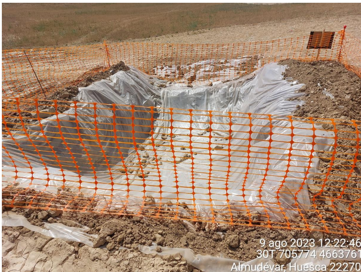
Imagen 2. Pozo de lavado de la SET realizado correctamente.
