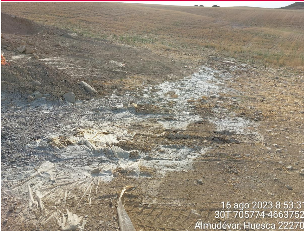
Imagen 1. No conformidad leve. Pozo de lavado de la SET desbordado provocando la contaminación del suelo
