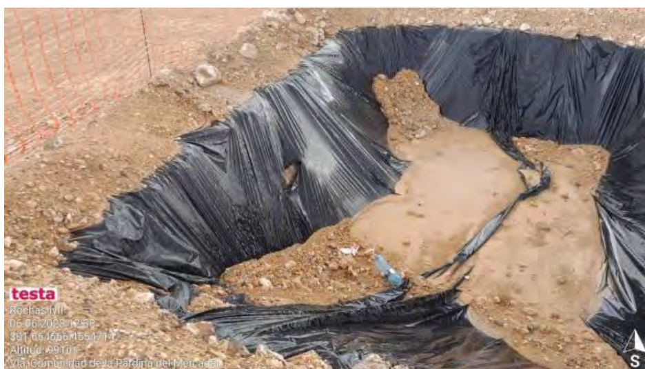
Pozo a la espera de reparar .
